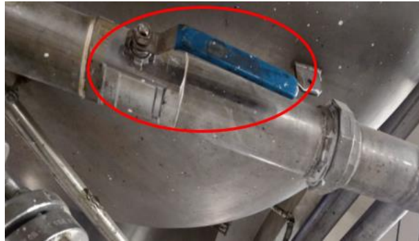
Gambar 4. Manual Valve Sebelum Perbaikan (Tidak Beridentitas)
